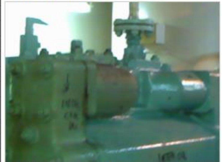
IR_7912.jpg FLIR E60 49031470
